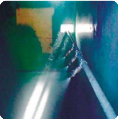
Pulverización de agua con inyectores
