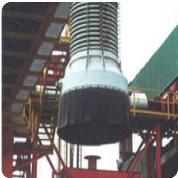
Figura 2.16 Mangas telescópicas de descarga. Las tres mangas permiten un llenado uniforme de la caja sin necesidad de mover el camión
